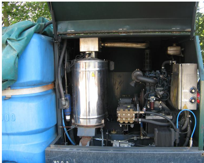
Figuur 11. Brandergedeelte met (v.l.n.r.) watertank, twee branders (in lijn), twee waterpompen en een dieselmotor (drukregeling is via draaiknoppen op zijkant van toestel, niet zichtbaar op deze foto).
